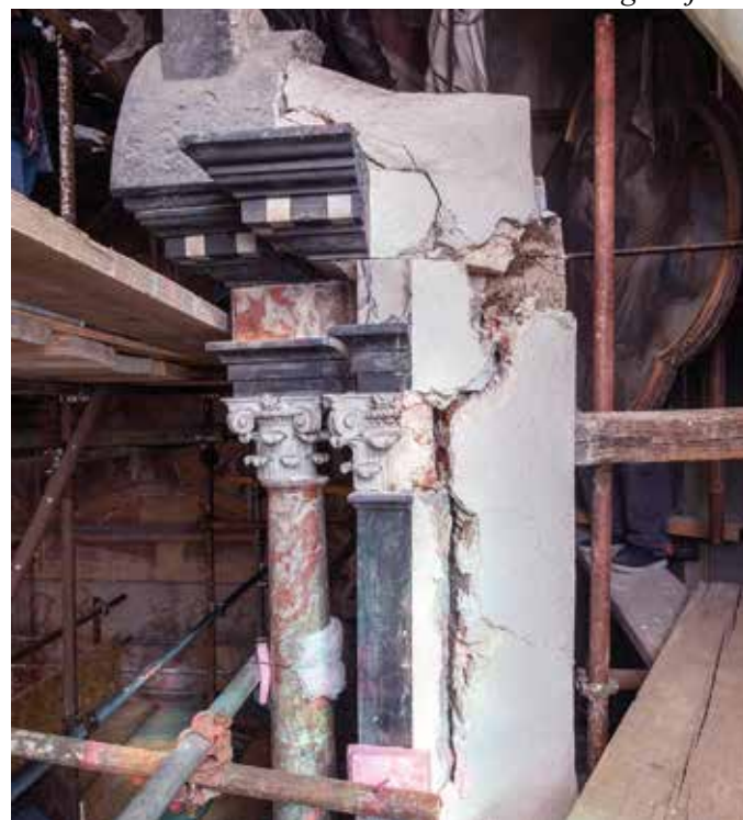
Dio oštećenog glavnog oltara M. B. Remetske
